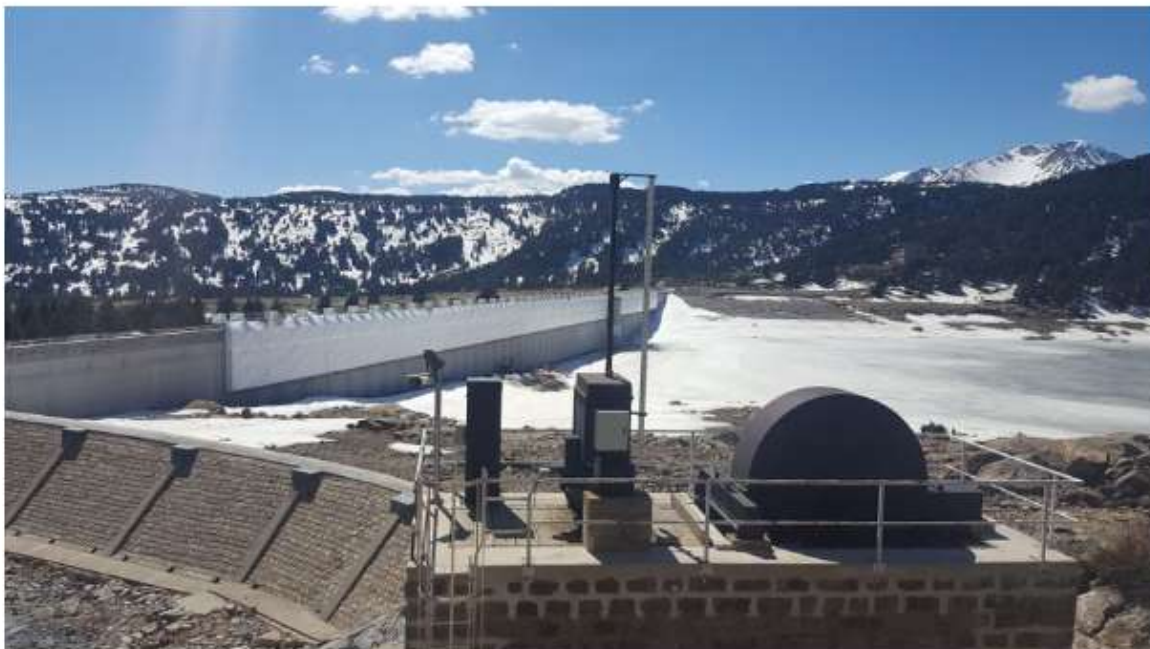
Un énorme échafaudage a été suspendu sur tout le long du barrage © Radio France - Sébastien Berriot
